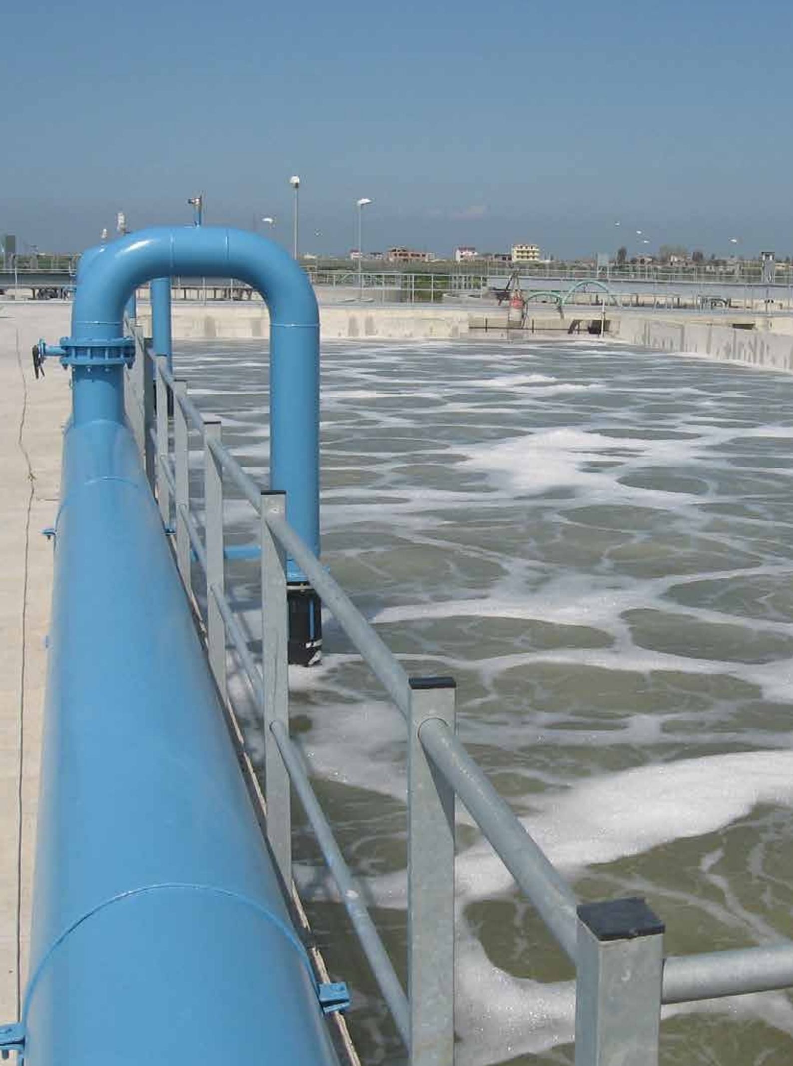
Costruzione degli impianti di depurazione di Durazzo, Lezhe e Saranda - Albania Construction Works and Installation for Constructed Treatment Wetlands - Durrës, Lezhe e Saranda - Albania
