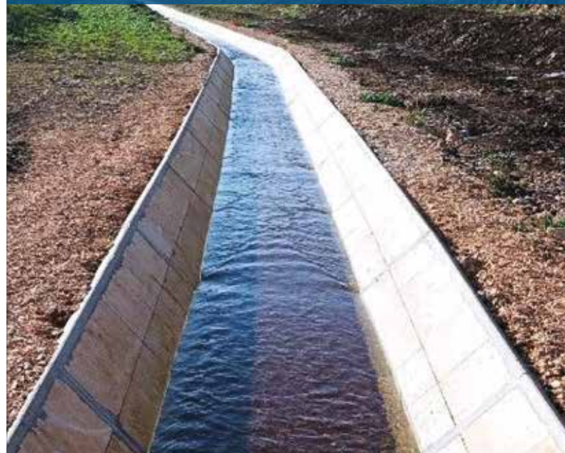
Sistemazione idraulica del canale di Jesce in agro di Altamura (BA) - Italia Hydraulic arrangement of the Jesce canal in the countryside of Altamura (BA) - Italy
